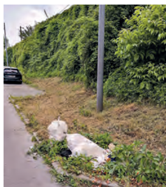
Müllablagerungen und Verwucherungen verhindern die Entwässerung.
