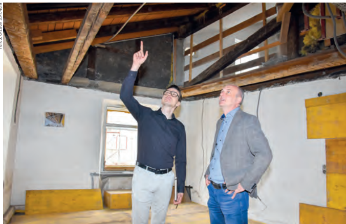
Projektleiter Mirza Kahrmanovic und Bauamtsleiter Ing. Peter Angerer im abgesperrten Büro des Standesamtes nach dem Entfernen der Deckenbalken.
